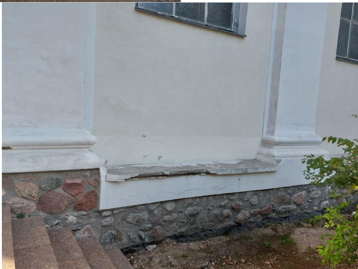
Foto. 15 Elewacja zach._ ubytki
