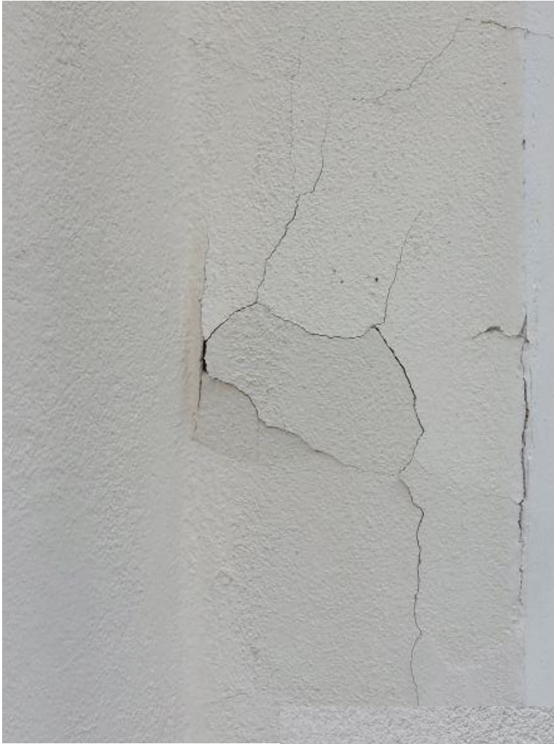
Foto. 3 Spękania i odspojenia
