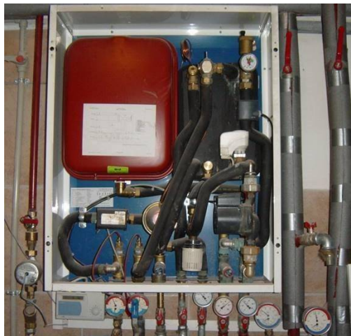
Węzeł ciepły w budynku jednorodzinny, fot. z archiwum Przedsiębiorstwa Energetyki Ciepłej w Suwałkach Sp. z o.o.
