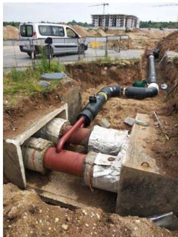
Termomodernizacja sieci przy ul. Pileckiego, fot. z archiwum Przedsiębiorstwa Energetyki Ciepłej w Suwałkach Sp. z o.o.
