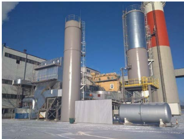
Instalacja oczyszczania spalin, fot. z archiwum Przedsiębiorstwa Energetyki Ciepłej w Suwałkach Sp. z o.o.
