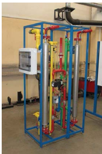
Węzeł ciepły w budynku wielorodzinnym, fot. z archiwum Przedsiębiorstwa Energetyki Ciepłej w Suwałkach Sp. z o.o.
