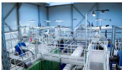
Instalacja biomasy, fot. z archiwum PEC w Suwałkach Sp. z o.o.
