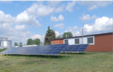
Instalacje fotowoltaiczne na OŚ w Suwałkach; fot. z archiwum PWiK w Suwałkach Sp. z o.o.
