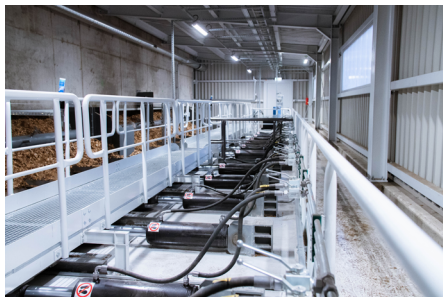
Instalacja biomasy; fot. z archiwum PEC w Suwałkach Sp. z o.o.
